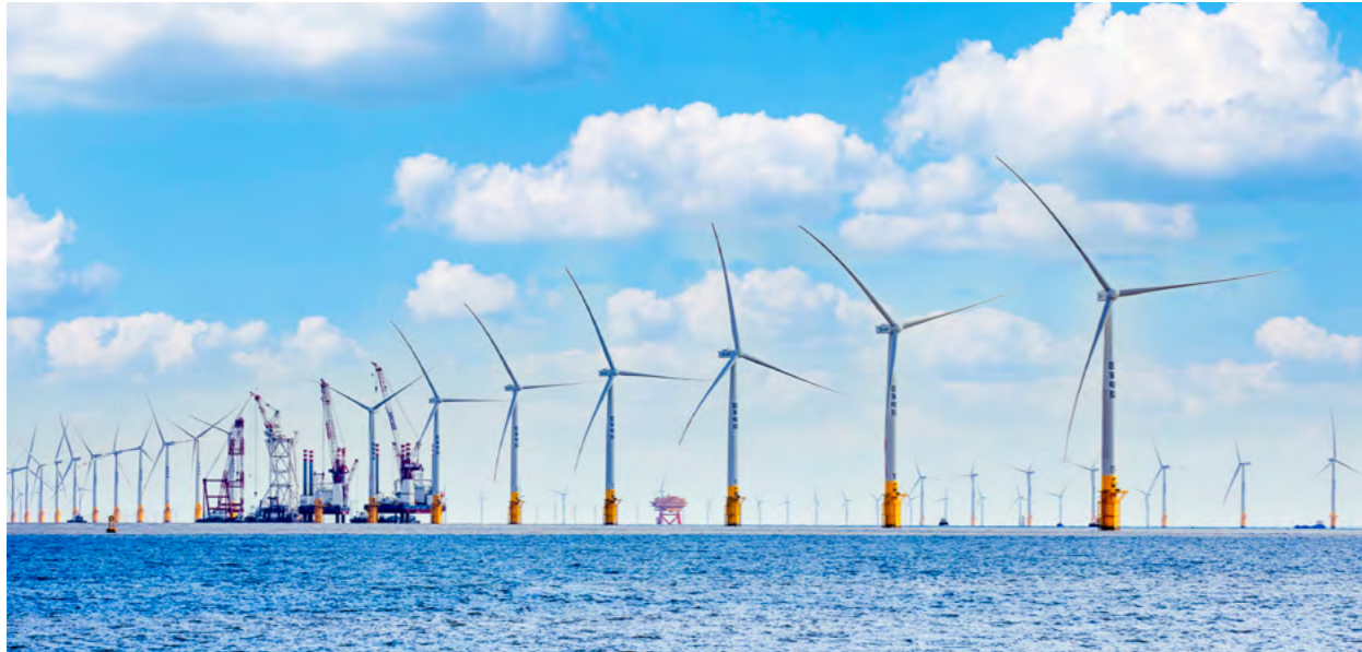
2021 年 12 月 9 日，国内在建单机容量最大的海上风电项目——江苏如东 800MW 海上风电项目（H4#、H7#）200 台风机全部并网发电
