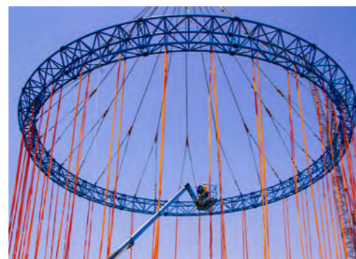
在“国和一号”示范工程某大型模块吊装现场，工人乘坐升降机检查吊具
