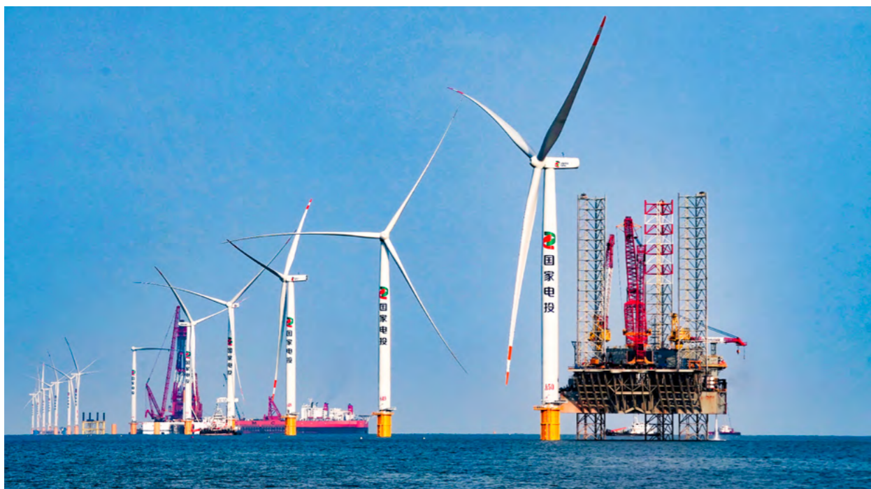
2021 年 12 月 16 日，山东首批海上风电示范项目、国家电投在山东首个海上风电项目——半岛南 3 号项目实现全容量并网发电
