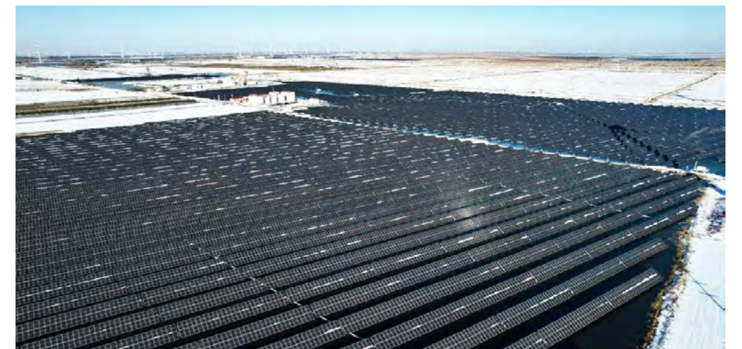
河北省黄骅市吕桥镇 87.6 兆瓦渔光互补光伏发电项目并网投产
