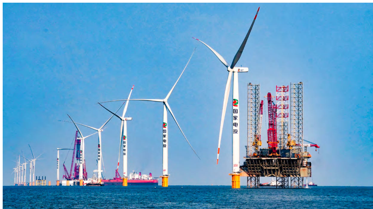
2021 年 12 月 16 日，山东首批海上风电示范项目、国家电投在山东首个海上风电项目——半岛南 3 号项目实现全容量并网发电
